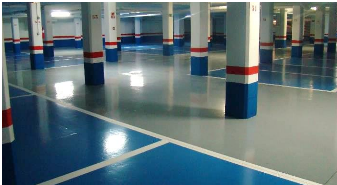
Figura 5.3: Ejemplo de sistema terminado en parking.
